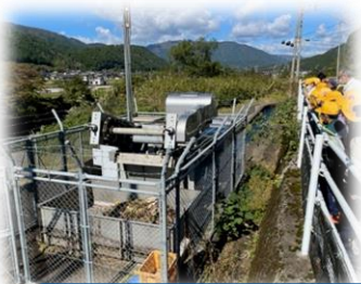
除塵機という機械を実際に動かしてみせていただきました。
